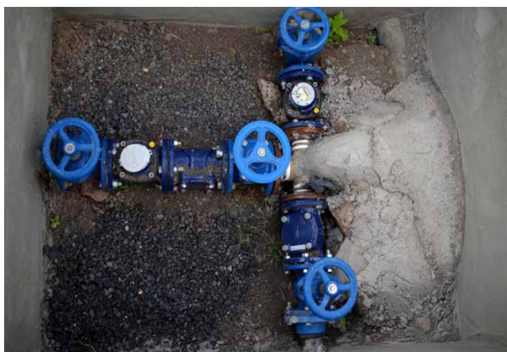
La modernización de la red es una necesidad.
