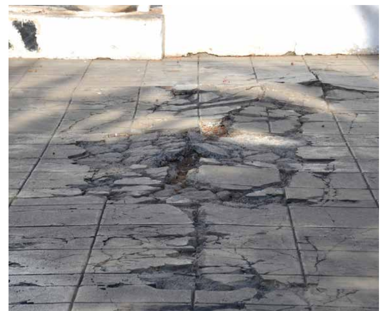
El mal estado del pavimento es un enorme peligro para la ciudadanía.
